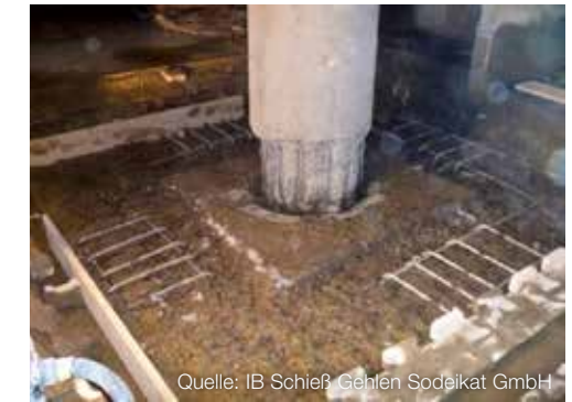
4 Notwendige Instandsetzungsmaßnahme bei Fundament unter Pflasterbelag
