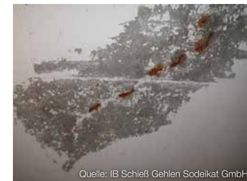
5 Korrosion der unteren Bewehrungslage eines Zwischendecks infolge eines Trennrisses
