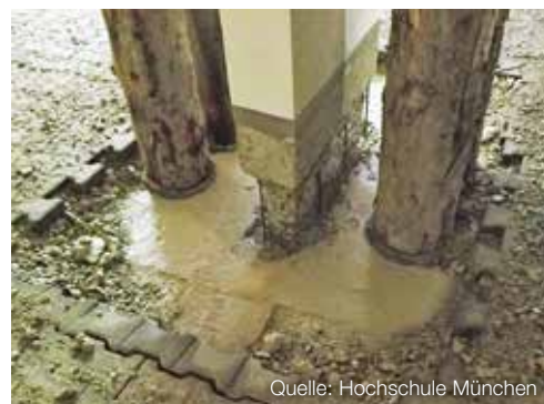
1 Bewehrungskorrosion an einem Stützenfuß infolge Chlorideinwirkung
