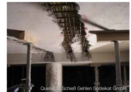
6 Instandsetzungsmaßnahme entlang eines Trennrisses
