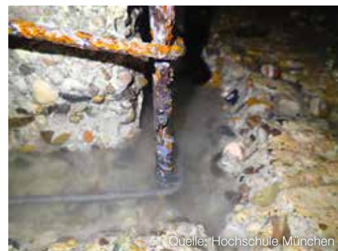
2 Detailaufnahme von Querschnittsverlust an Bewehrung
