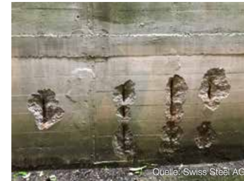
3 Korrosionsbedingte Betonabplatzungen im Wandfußbereich
